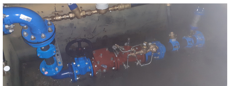
Stabilisateur de pression sur la conduite d'adduction
